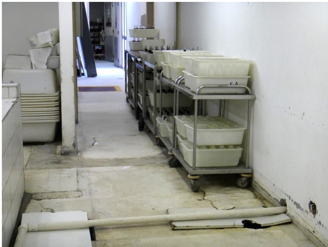
Figura 15 – Detalhes do piso da área de higienização, Biotério de Criação, Lacaen C
