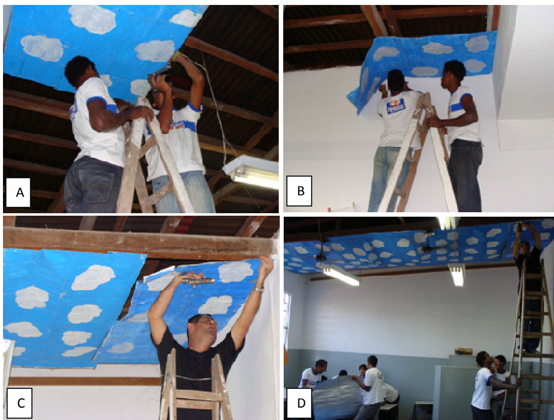
Figura 9: Instalação de mantas isolantes térmicas sob o telhado da sala de aula com ajuda de alunos do 9º ano. A, B, C e D- alunos do 9º ano e professor de Ciências (C) executam tarefa de instalação das mantas isolantes térmicas, fixadas sob o madeiramento com grampeador de estofador.
