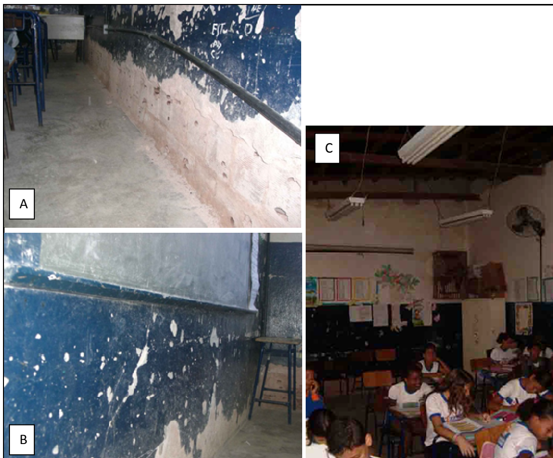
Figura 10: Sala de aula da Escola Municipal Presidente Costa e Silva, no município de Duque de Caxias, na Baixada Fluminense, antes da instalação da subcobertura isolante térmica e da reforma realizada com recursos da Faperj. A e B- detalhes da parede e da instalação elétrica externa. C- vista geral da sala de aula, com infraestrutura e condições de limpeza das paredes inadequadas para o trabalho e o estudo.
