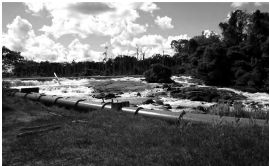
FIGURA 23. Aspecto da Pequena Central Elétrica de Jandu-Cachoeira, que abastece o 6.º PEF. Acervo da autora.
