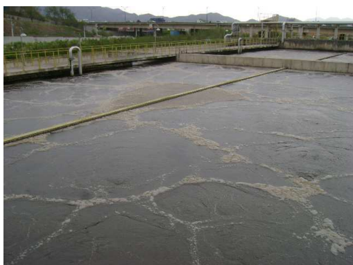
Figura 10.1.3.4. Tanque de aeração
