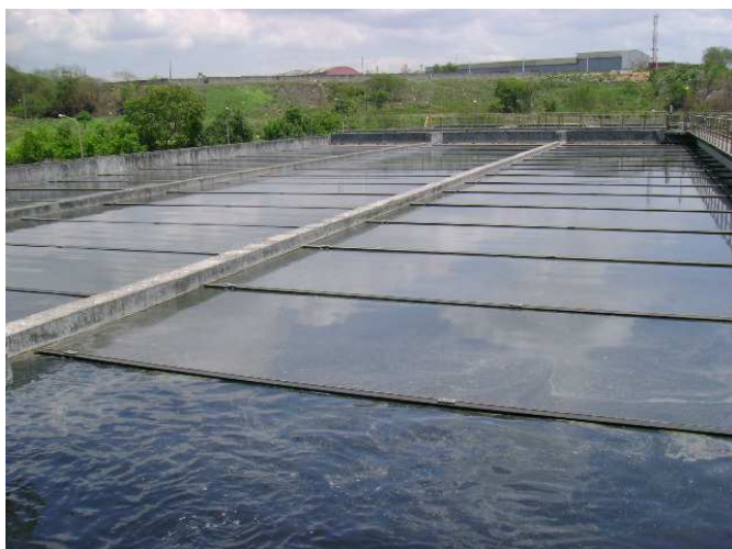
Figura 10.1.3.3. Decantador primário em operação
