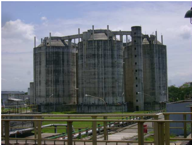
Figura 10.1.3.7. Digestores anaeróbios de lodo
