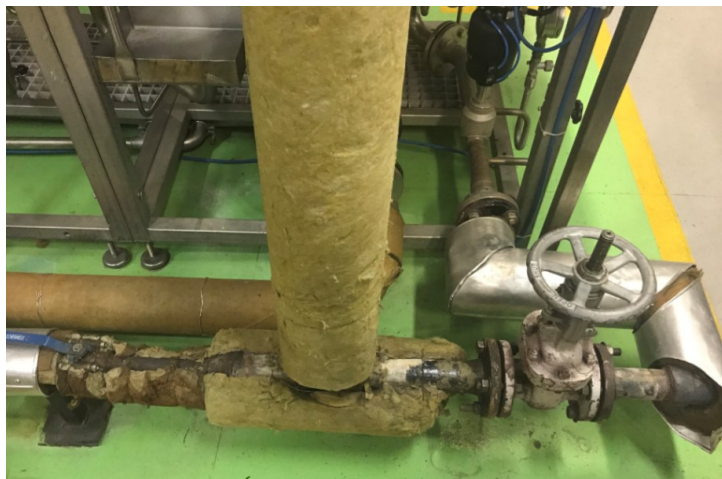
Figura 27: Tubulação dos destiladores.
