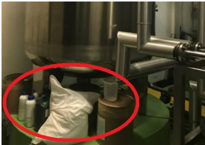
Figura 31: Tanque de armazenamento de WFI.
