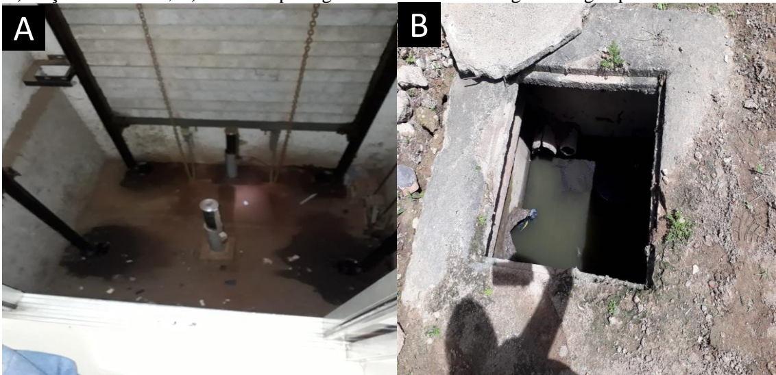
Figura 9 Potenciais criadouros de mosquitos no HC que foram submetidos ao tratamento com larvicidas. A) Poço de elevador; B) Caixa de passagem – sistema de drenagem de água pluvial.
