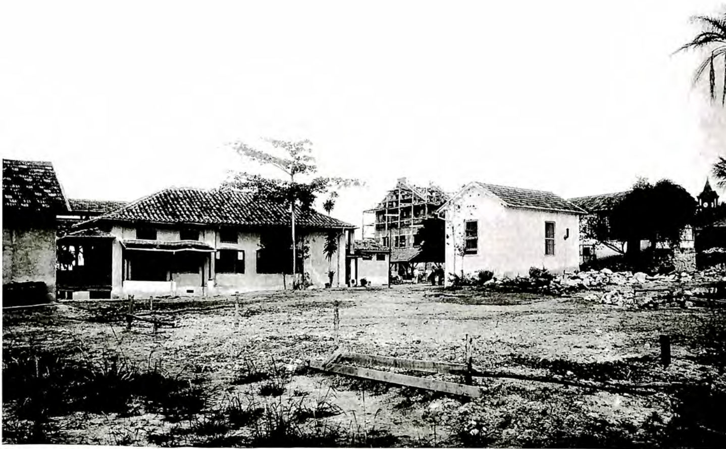
Vista do Instituto Soroterápico Federal, durante a construção das novas edificações projetadas por Luiz Moraes Jr. Até a finalização da construção do edifício principal, estas construções conviveriam no mesmo sítio. (C.1904 – DAD/Fiocruz)
