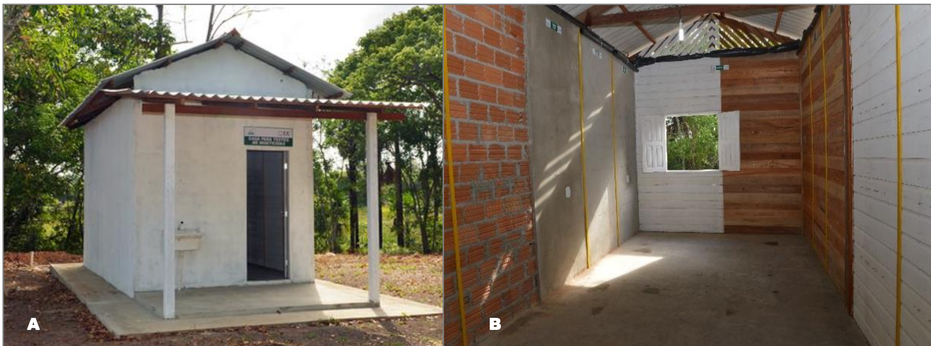
Figura 3.6 – Casa teste: A - visão externa frontal e lateral da superfície de alvenaria com reboco - ACR pintada de tinta acrílica; B - visão interna das superfícies lateral de alvenaria sem reboco - ASR e ACR divididas em faixas para aplicação dos inseticidas, visão da parede dos fundos (controle) das superfícies de madeira com pintura - MCP e madeira sem pintura - MSP, teto com telhas de fibrocimento e piso em cimento queimado. Localizada no município de Macapá-Amapá, Brasil.
