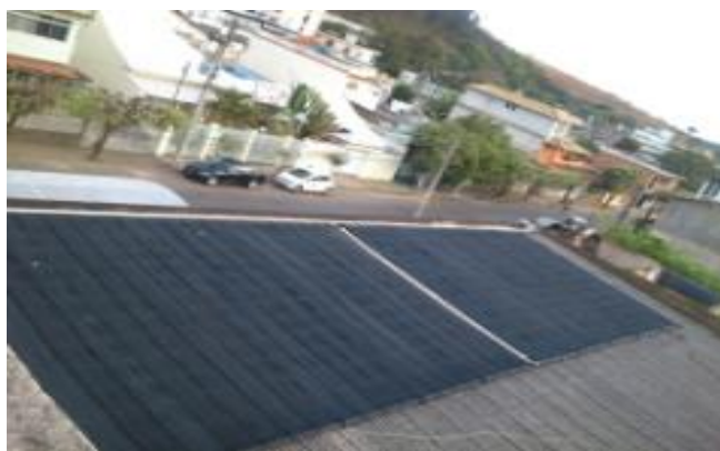
Figura 42: painel de energia solar instalado na Academia Studio “S” em decorrência do projeto.
