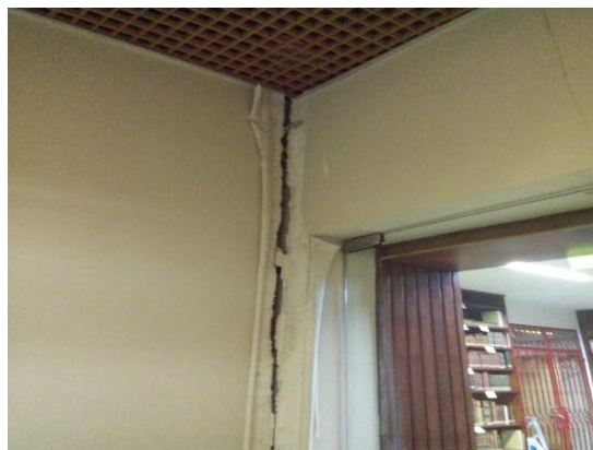
Rachadura no ambiente do acervo
