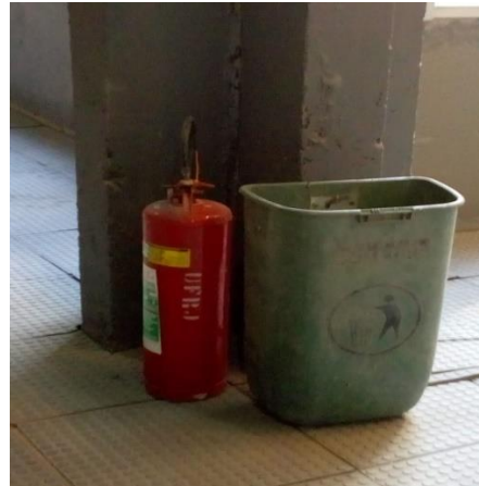
Subsolo – extintor sem sinalização
