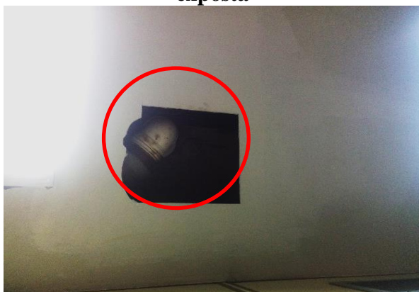
Forro avariado - tubulação hidráulica exposta
