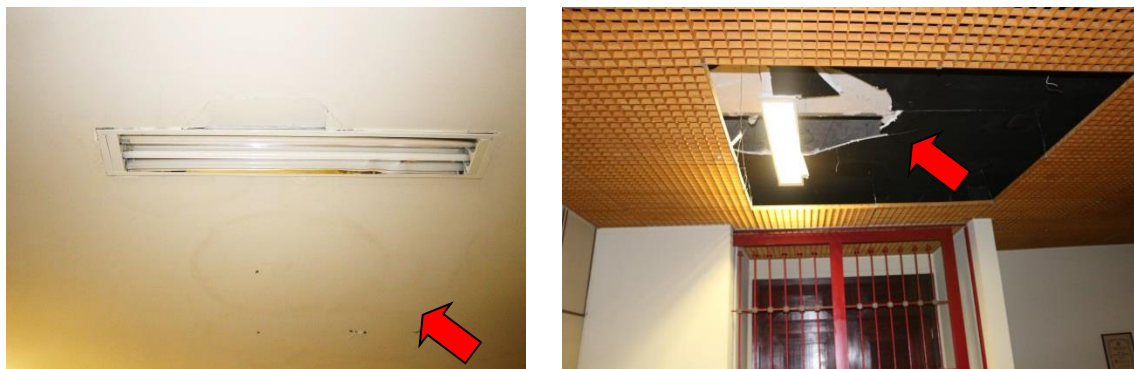
Fig. 23 – Teto com infiltrações e buracos
