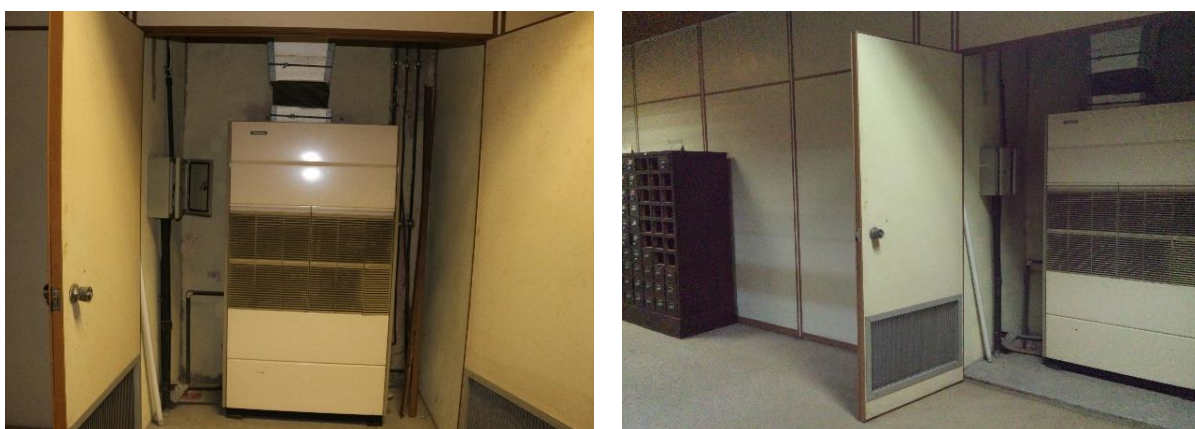
Fig. 20 – Imagens do ar condicionado central quebrado
