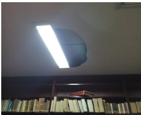
Forro avariado - fiação exposta
