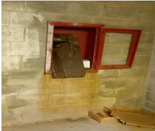
Subsolo – ausência de hidrante
