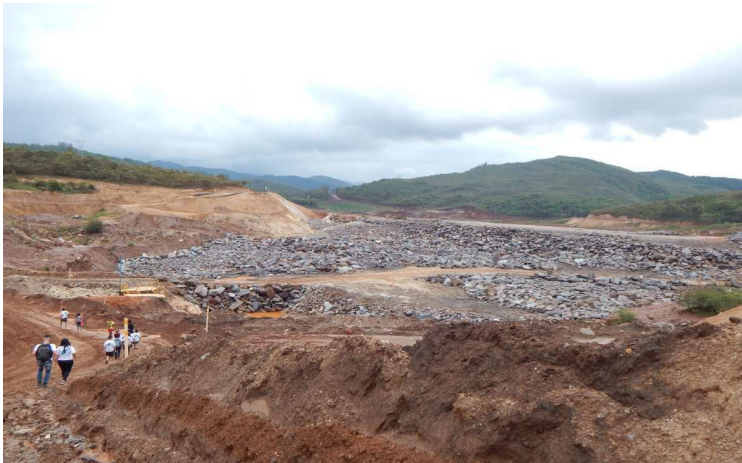
Figura 5 – Região atingida pela lama em Bento Rodrigues, em obras pela Samarco .
