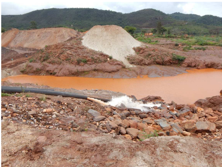
Figura 7 – Obras da Samarco na região atingida pela lama.
