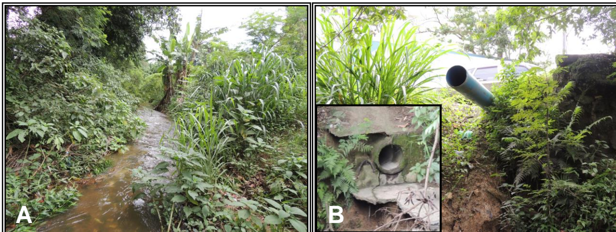
Figura 16: P11. Baixo Curso do Rio Camorim, Vertente Leste. Fisionomia geral do ponto (A), com tubulações de esgoto e manilhões de drenagem urbana (B).
