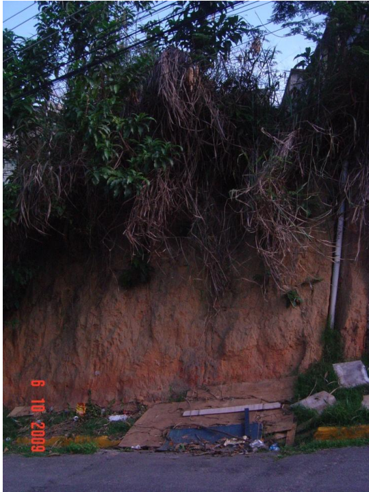
Foto 17: Presença de vegetação e lixo na rua do Bairro.
