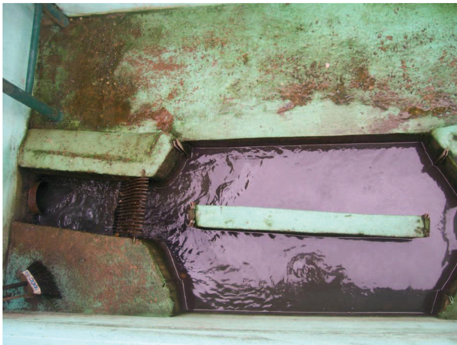
Figura 8 – Entrada de ETE: Gradeamento, Caixa de areia e Calha Parshall
