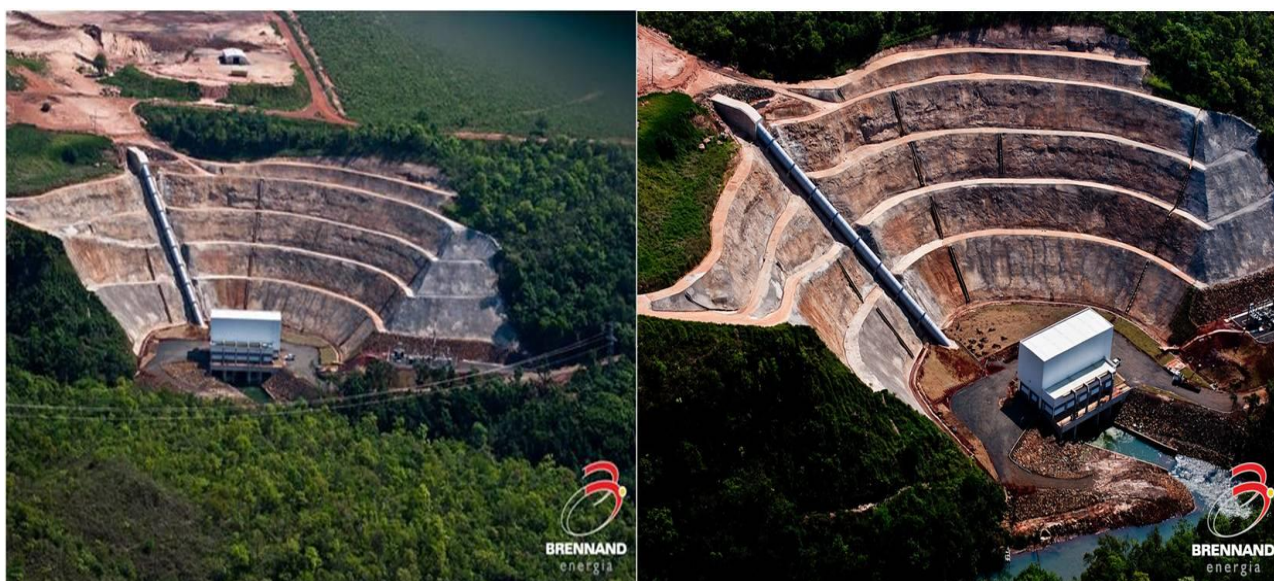
Figura 4.2. Usina hidroelétrica PHC Planalto situada no município de Cassilândia/MS ainda em construção. (Fonte: www.brennardenergia.com.br )
