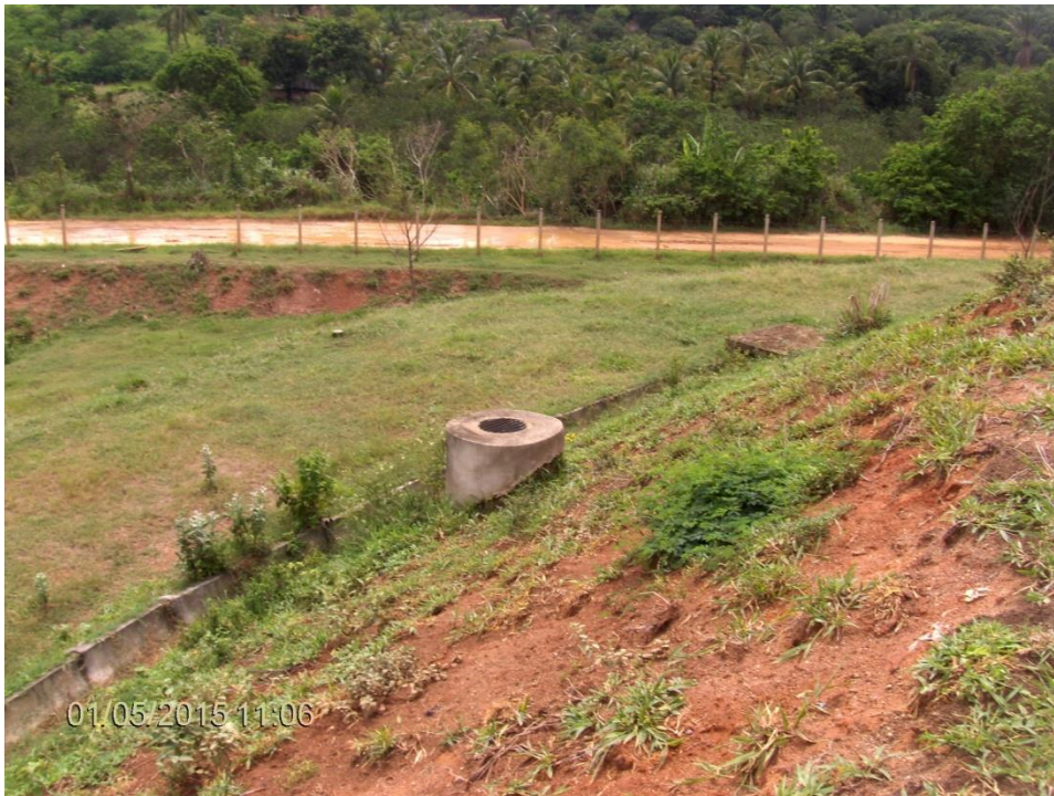
Figura 13 – Vista do sistema de drenagem do aterro remediado do município de Seropédica.
